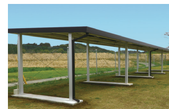
公園 10.2kW(宮崎県)
